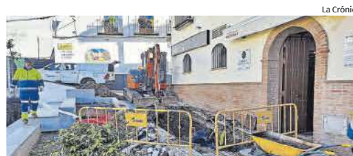
Operarios de Aqualia trabajan en punto donde reventó la tubería.
