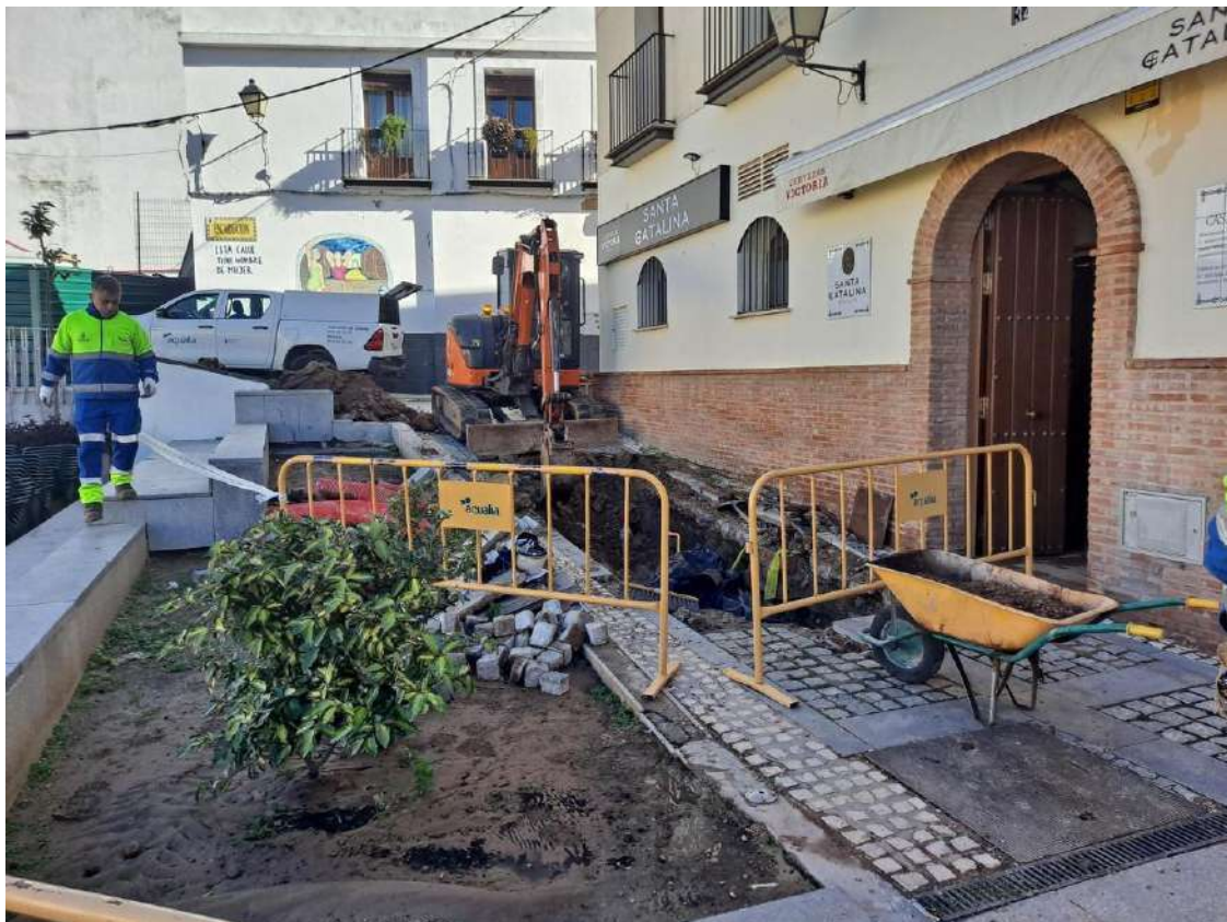
Operarios de Aqualia trabajan en el lugar donde se produjo el reventón fortuito esta madrugada.
